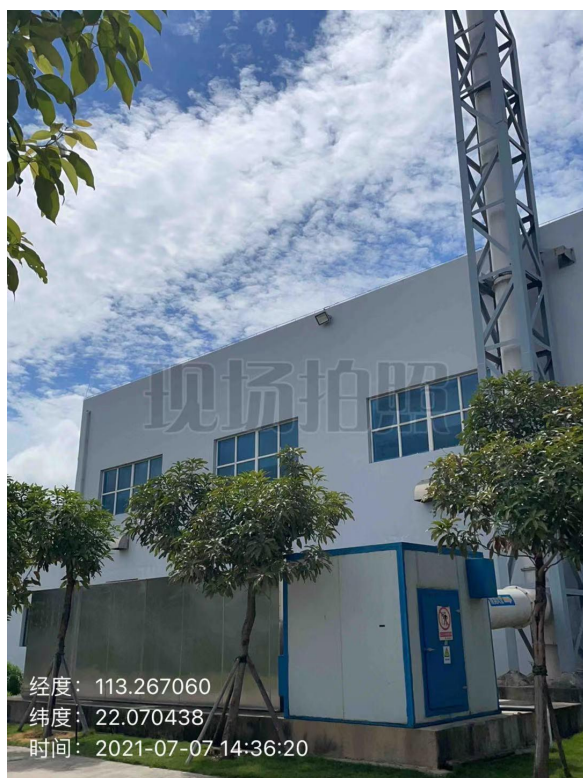
废气处理设施
